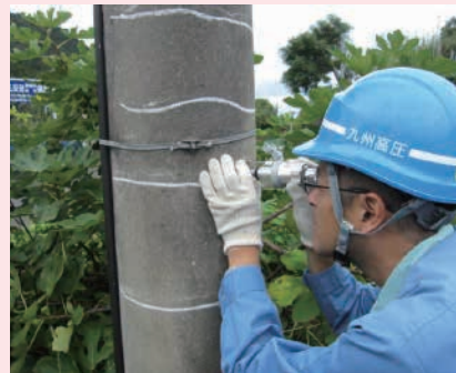
ひび割れ調査(測微鏡)
