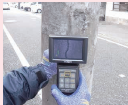
ひび割れ調査(デジタル顕微鏡)
