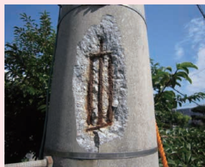
コンクリート剥離
