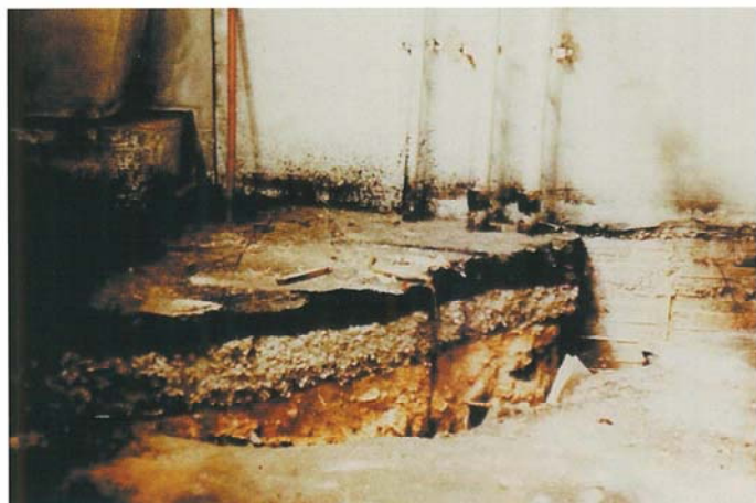
土間コンクリート床の破損
