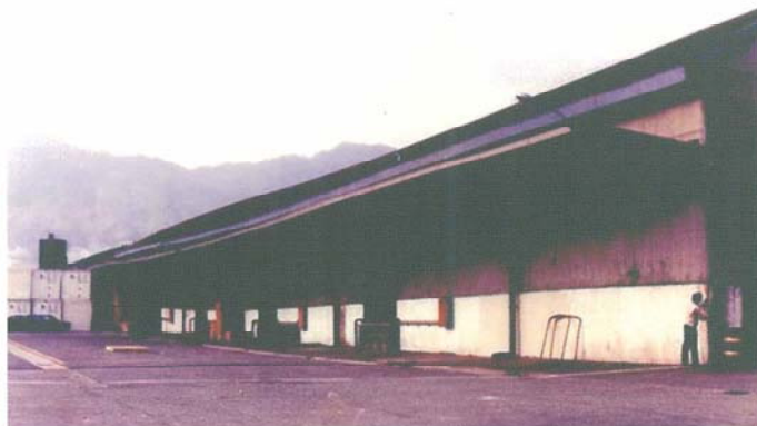
不同沈下建物例
